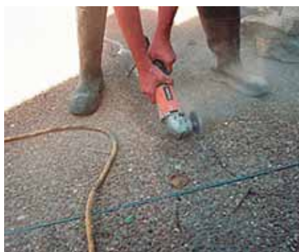
3. Cada reparación debe hacerse con los materiales y procedimientos adecuados para el tipo de daño, debiendo revisar siempre las Hojas Técnicas y Especificaciones de los fabricantes, además de seguir el procedimiento señalado en el proyecto.
